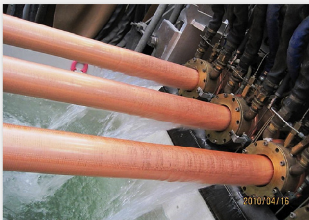
Bild 7: Wassergekühlte Kokillen im Bereich des Kokillenfensters (Quelle: SMS group)
